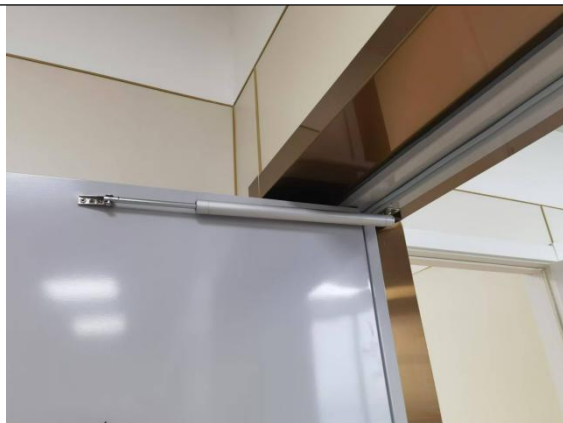
照片15 闭门装置
