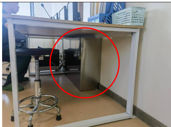
照片8 控制室电缆口
